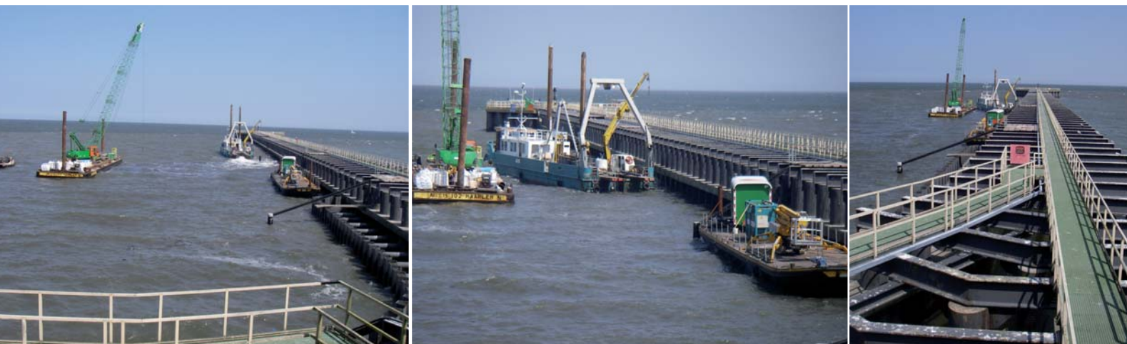
Figuur 3: Kathodische bescherming van damwanden bij de Eemscentrale in Groningen. De anodes zijn in dieptebedden geplaatst, vijf meter buiten het kunstmatig kanaal.
