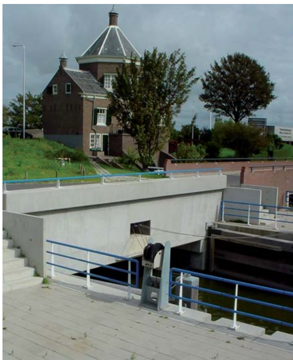
Figuur 5: Hoogheemraadschap Delfland past kathodische bescherming toe bij het beschermen van de damwanden in een nieuwe waterdoorgang bij Maasland.
